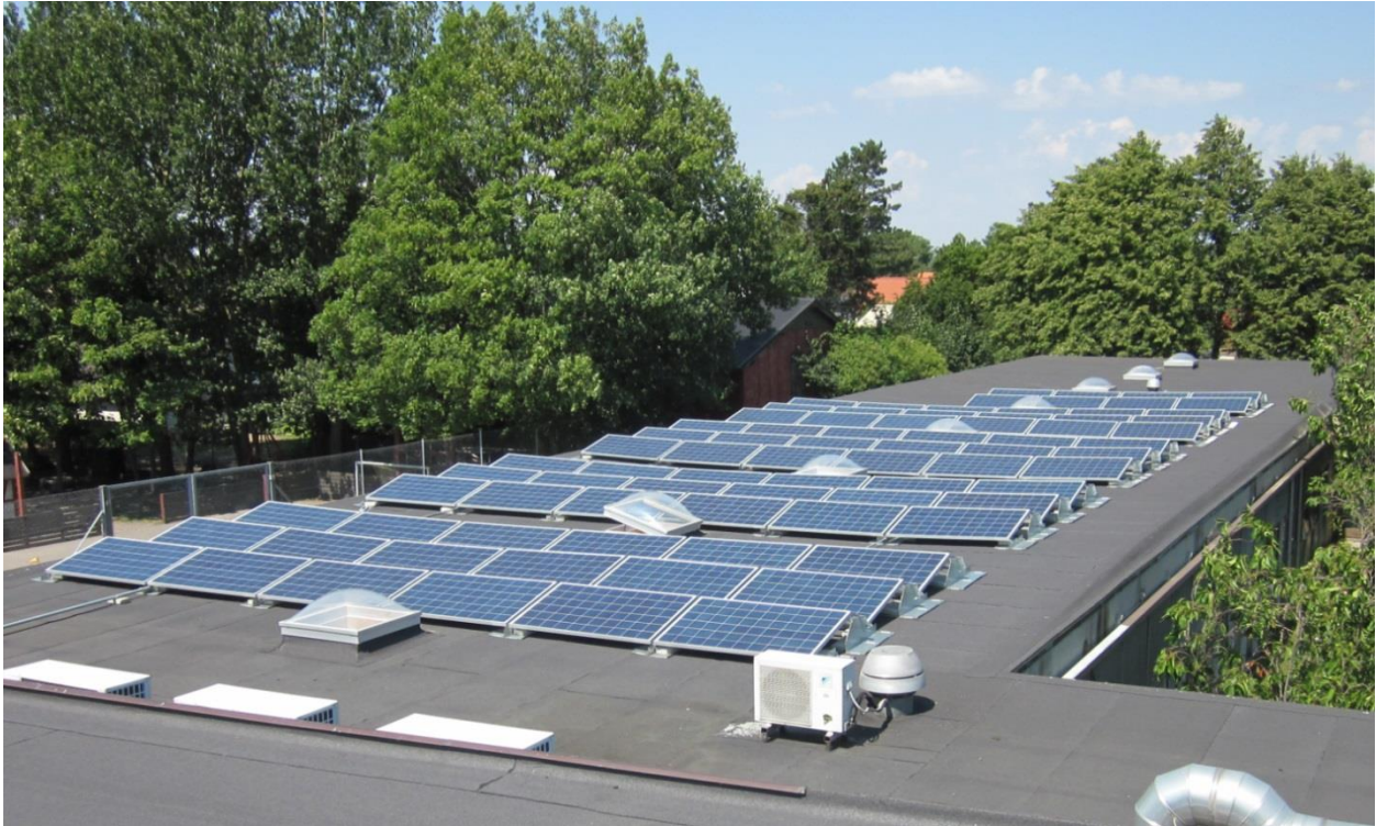
18 KW Solcelleanlæg opsat på Rådhusets tag februar 2014.
